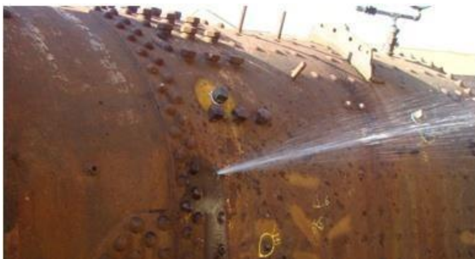
Figura 2.10 Vazamento em duto. Fonte: http://www.revistaalcoolbras.com.br (2013)
