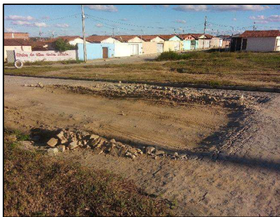
Foto 7 : Calçamento de rua de acesso à feira sudoeste danificado, em 01/07/2018
