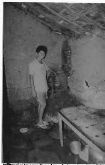
Infiltrações levaram Bernadete a isolar a área da cozinha
