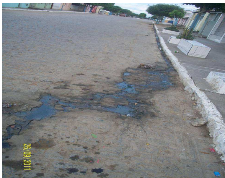
IMAGEM 02- Esgotamento á céu aberto na Rua José Mariano Barbosa centro da cidade de Gado Bravo PB
