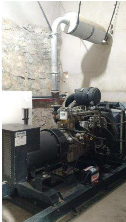
Figura 7 – Gerador 1, 180 kVA instalado na Agroindústria.
