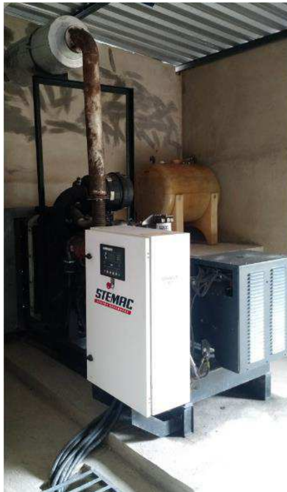
Figura 8 – Gerador 02, 180 kVA instalado na Agroindústria.
