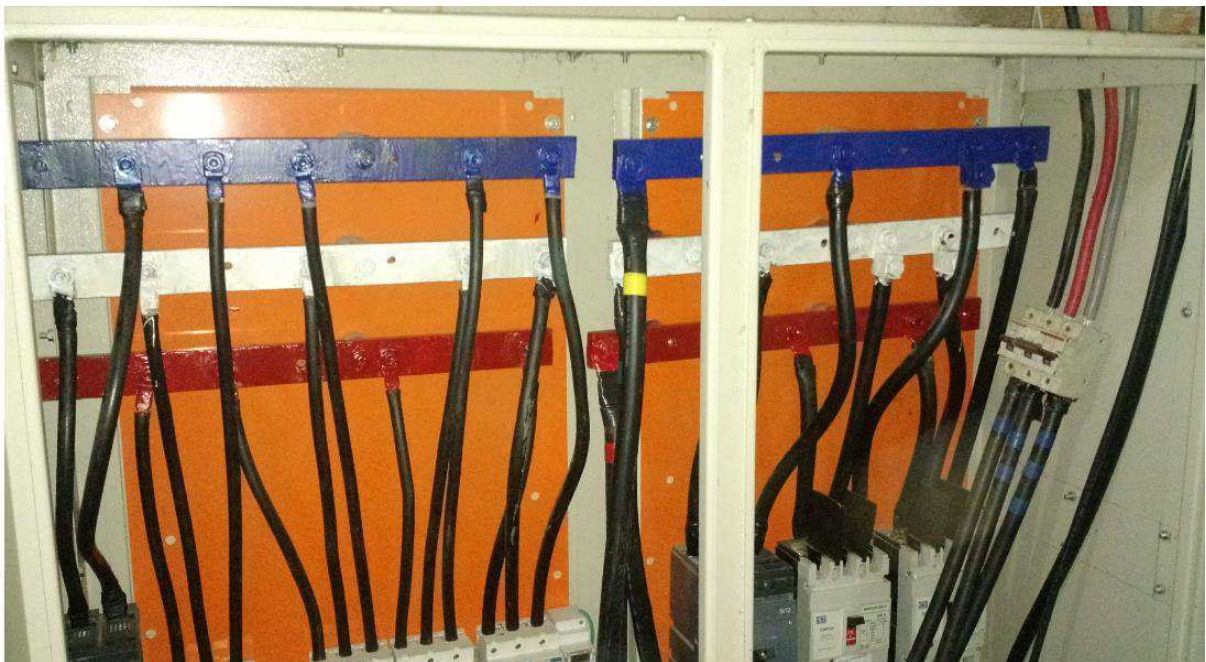
Figura 9 – Quadro de Comando para Bomba Submersa
