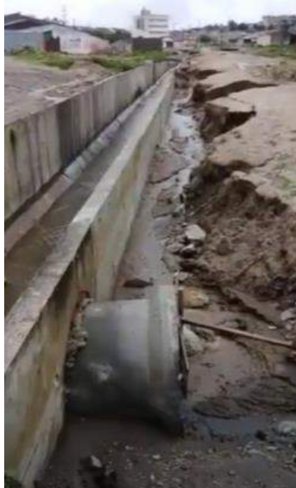
Figura 27: Erosão do solo nas margens do Canal da Ramadinha
