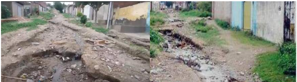
Figura 24: Erosão do solo da rua Marinaldo Vitorino Filho - 2018
