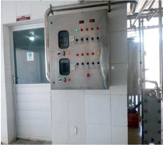
Figura 11A: Painel de controle.
