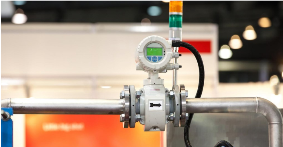
Fotografia 10 - Exemplo de sistema de medição de vazão instalado.
