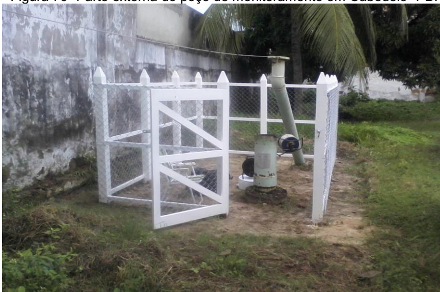
Figura 76- Parte externa do poço de monitoramento em Cabedelo- PB.
