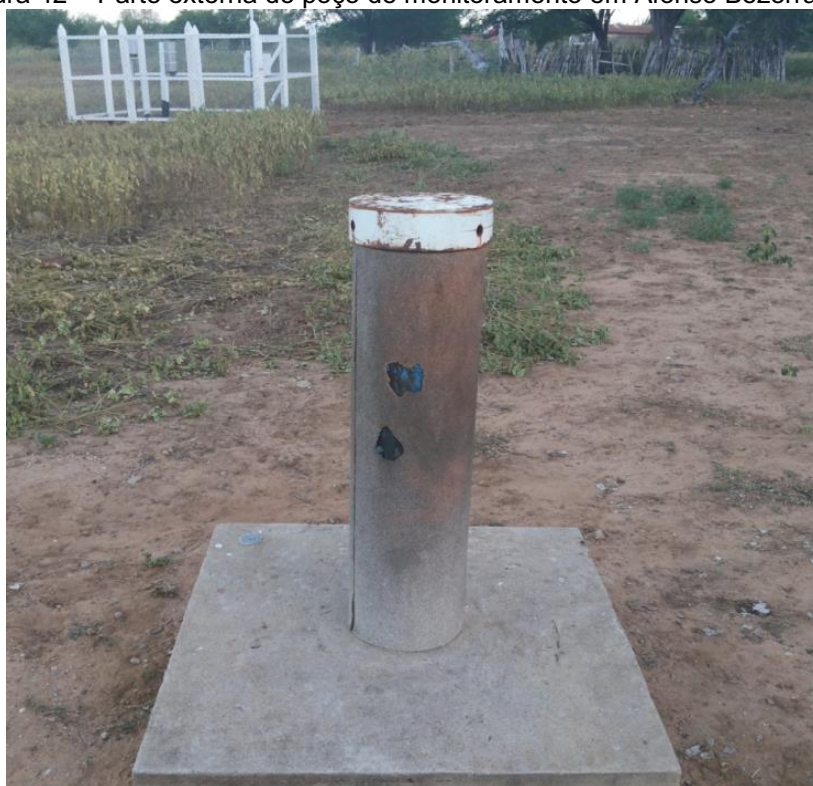
Figura 42 – Parte externa do poço de monitoramento em Afonso Bezerra-RN.
