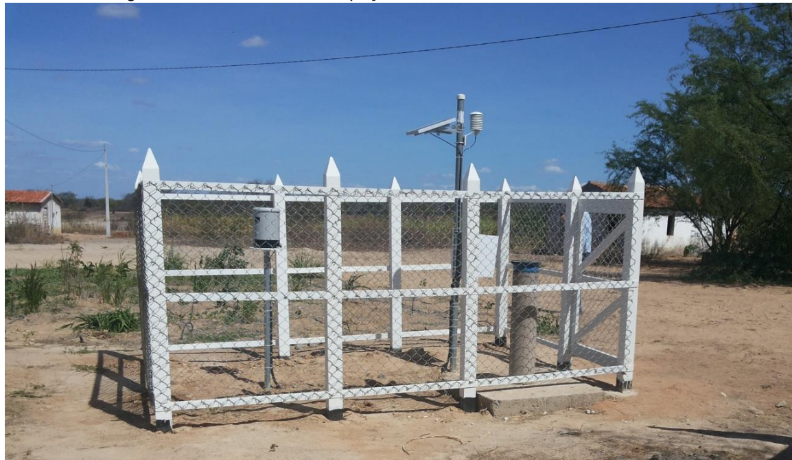
Figura 39 – Parte externa do poço de monitoramento em Caraúbas-RN.
