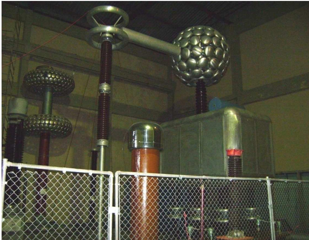
Figura 4.1 - Salão de Alta Tensão.
