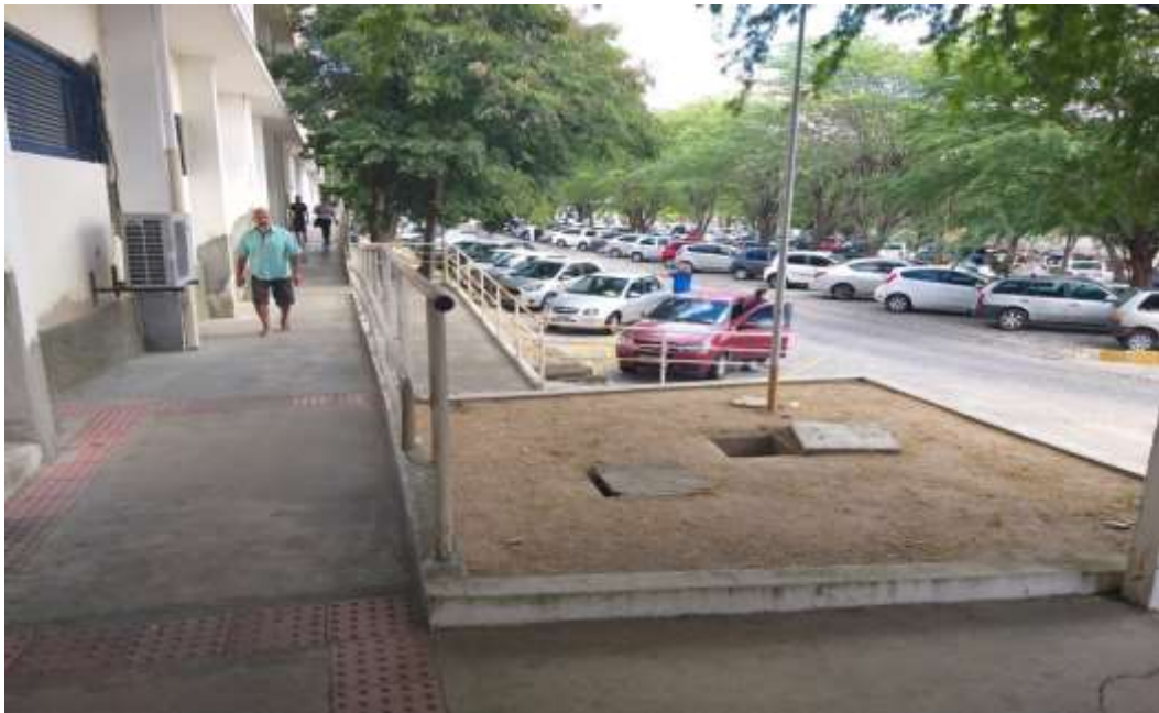
Figura 4 – Diferença de Níveis entre a Via de Circulação de Veículos e a Via de Circulação de Pedestres
