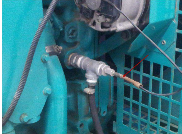
Figura 3.11 - Termopar instalado para medição da temperatura da água na entrada do motor.
