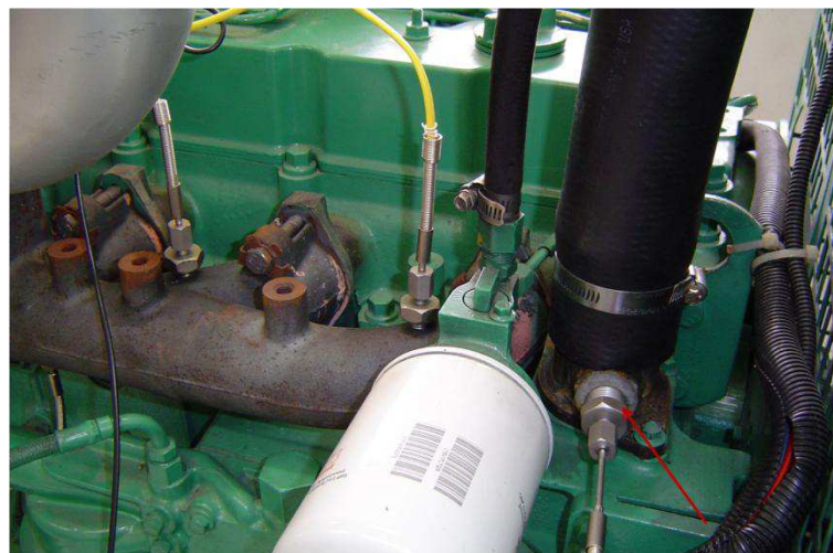
Figura 3.10 - Termopar instalado para medição da temperatura da água na saída do motor.
