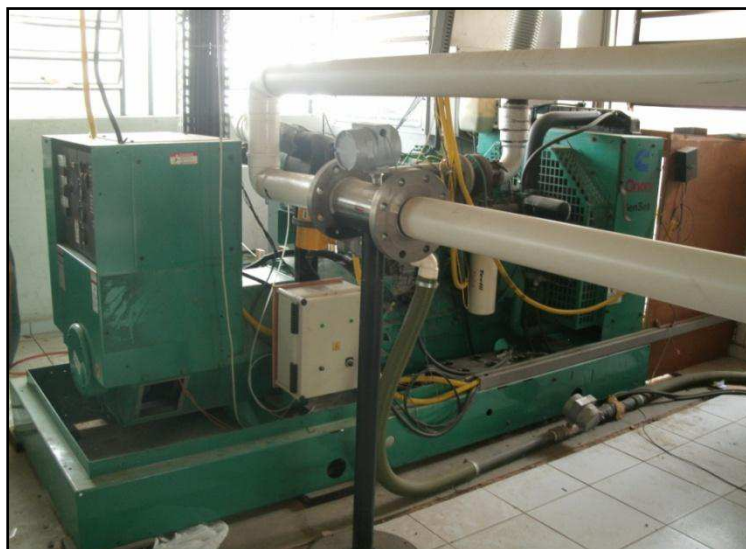
Figura 3.1 - Sistema de Termogeração Elétrica da UFCG.
