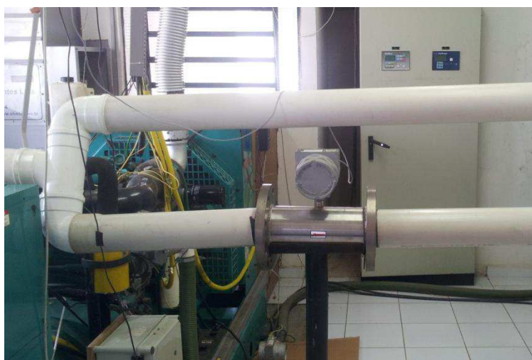
Figura 3.13 - Medidor de vazão de ar.
