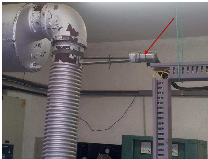
Figura 3.19 - Sonda do analisador de gases instalada.
