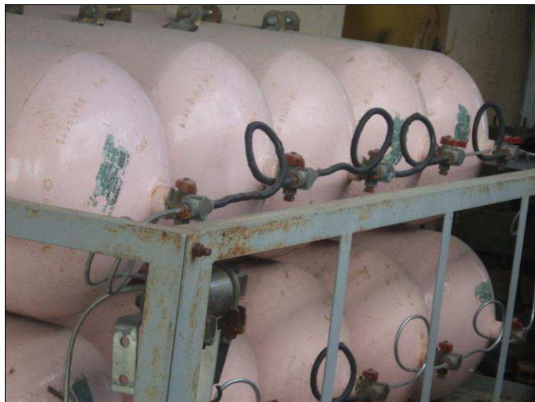
Figura 3.15 - Reboque com os 10 cilindros do sistema de armazenagem de gás.
