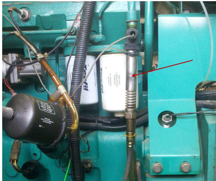
Figura 3.8 - Transdutor para medição da pressão do óleo lubrificante na galeria.
