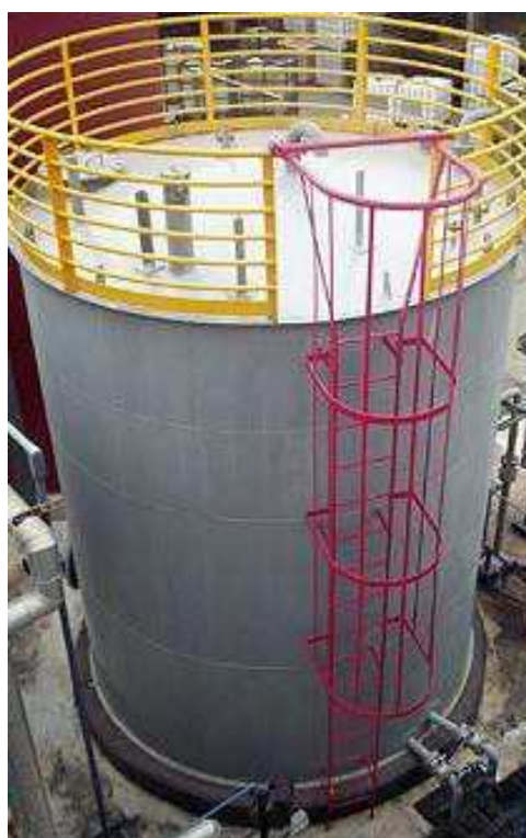
Figura 5 – Tanque de grandes dimensões utilizado na indústria (SOTANQUES, 2008)
