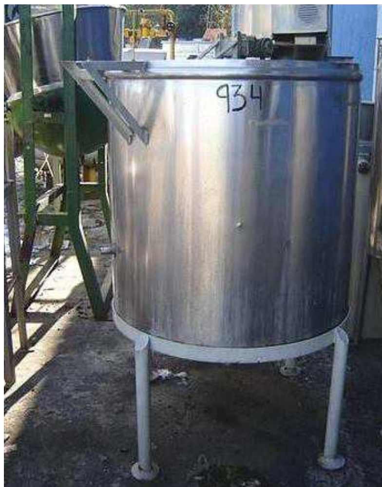
Figura 3 – Visualização externa de um tanque com serpentina e agitador (ABOISSA, 2008)
