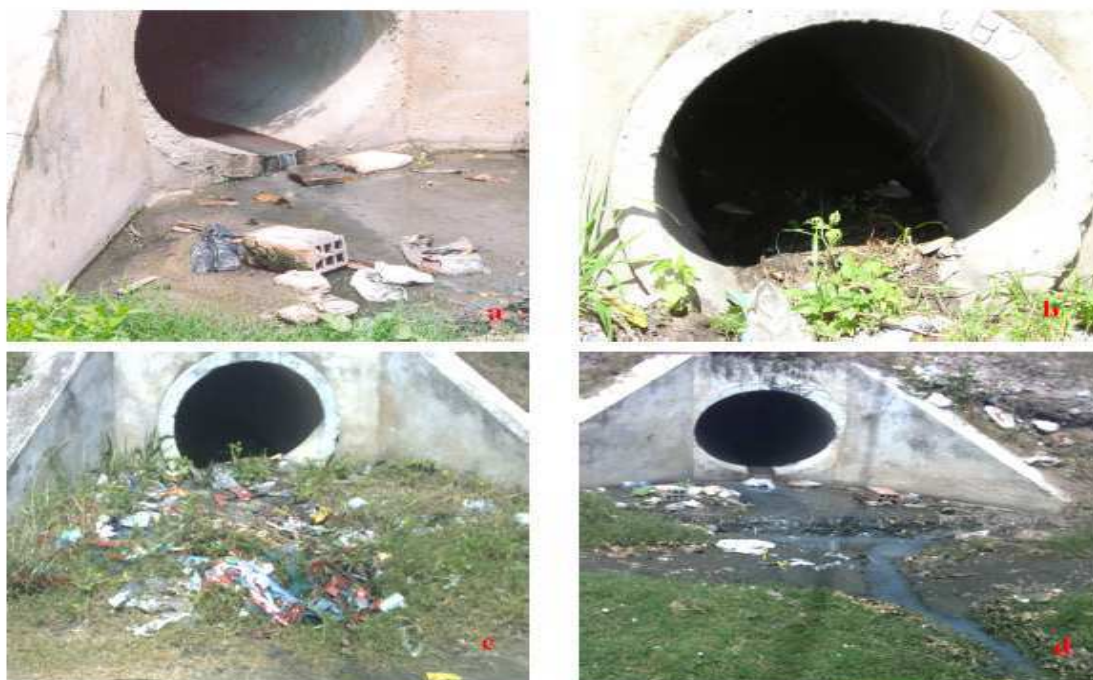
Foto 15: Galerias pluviais com escoamento de esgoto e resíduos sólidos de diversas origens (industrial e doméstico) em vários pontos, ao longo do açude. Fonte: Lucicláudio Barbosa (2010)
