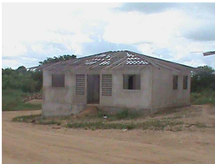
Escola inacabada em Cajá
