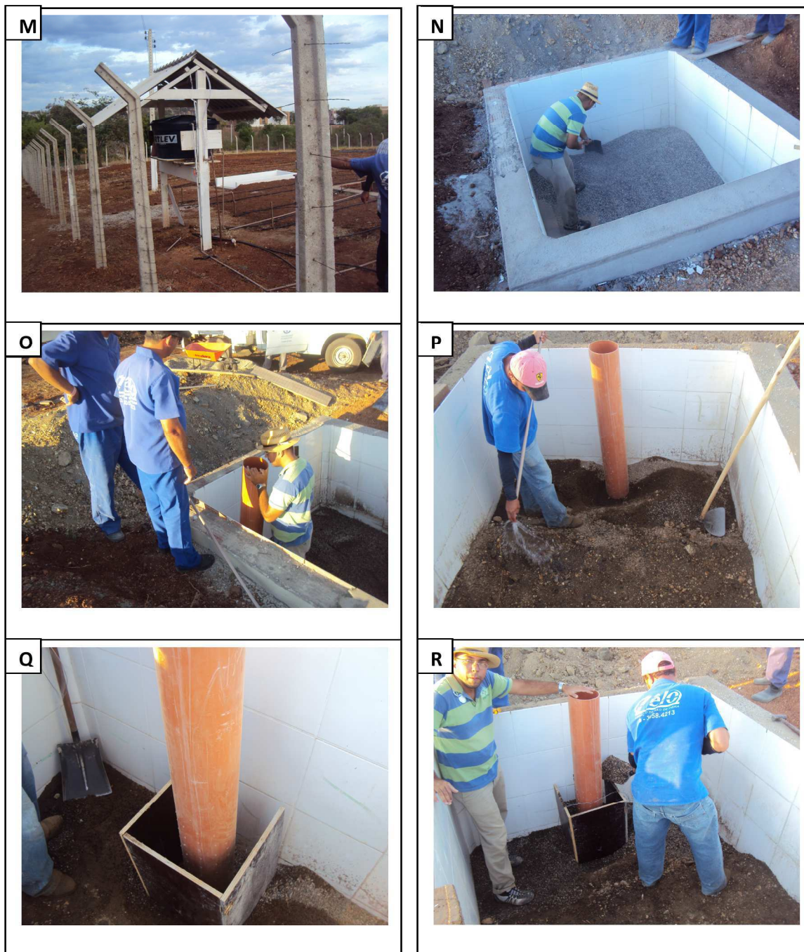
Fotos A 3.2. Vista do abrigo do sistema de abastecimento de água para irrigação do lisímetro (M); Colocação de brita no fundo do lisímetro (N); Instalação do tubo principal para abastecimento de água para o lisímetro (O), (P), (Q) e (R)
