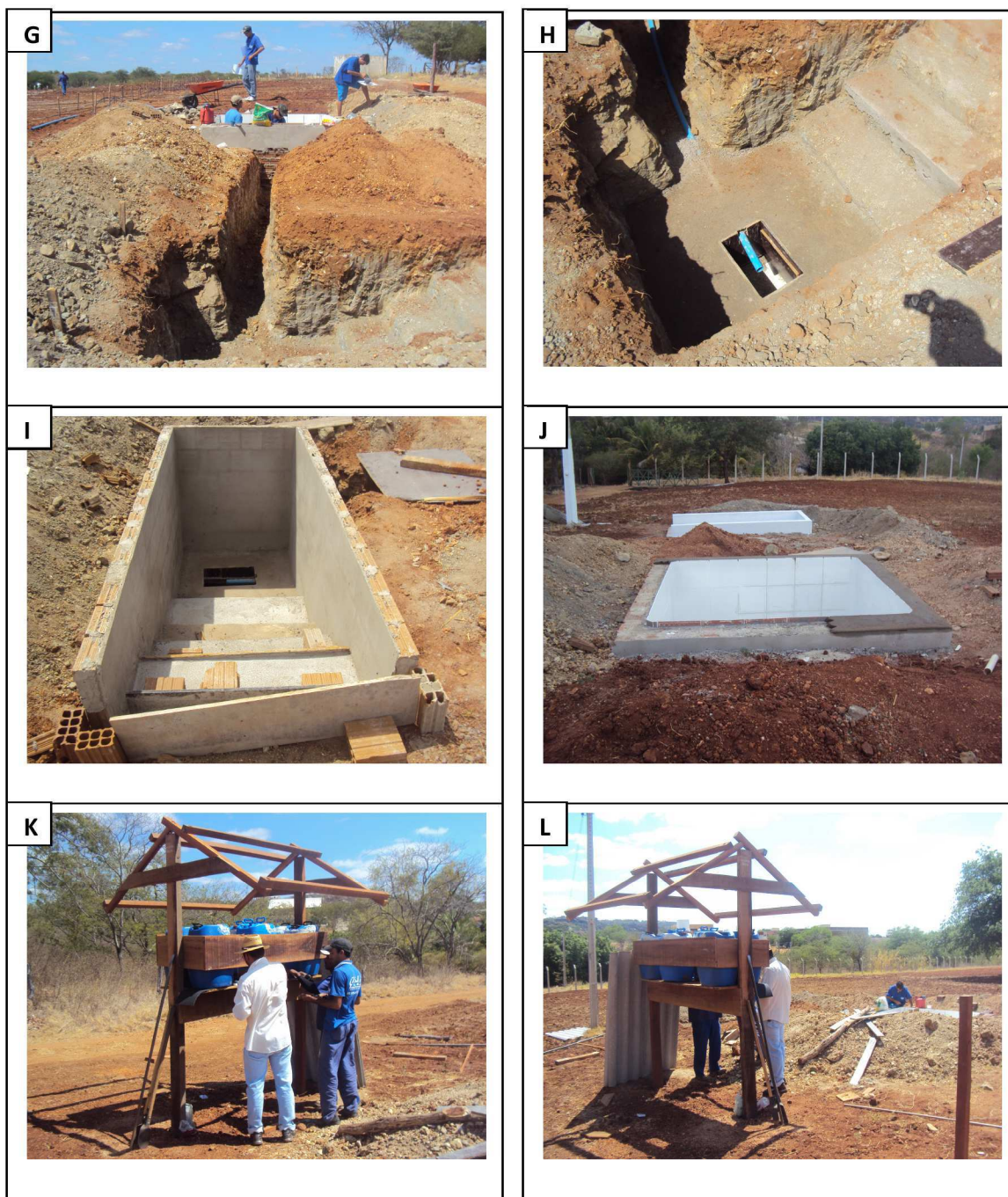
Fotos A 3.1. Construção do poço de coleta da drenagem em alvenaria (G), (H) e (I); Acabamentos finais do sistema do lisímetro e poço de drenagem (J); Execução do abrigo do sistema de abastecimento da irrigação do lisímetro (K) e (L)
