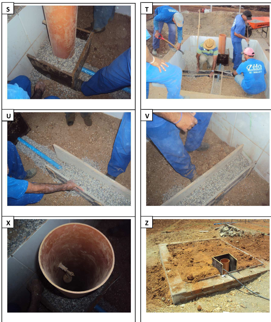
Fotos A 3.3. Instalação de tubos laterais investido como camada de brita para homogeneização da irrigação subsuperficial do lisímetro (S), (T), (U) e (V); Boia colocada no tubo principal para controle do nível de lençol freático no lisímetro (X); Vista do lisímetro depois da colocação do solo e do sistema de irrigação subsuperficial (Z)
