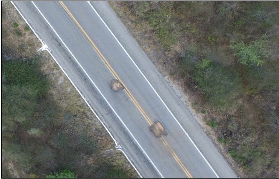
Figura 28 - Patologia do tipo panela - br-412/pb.
