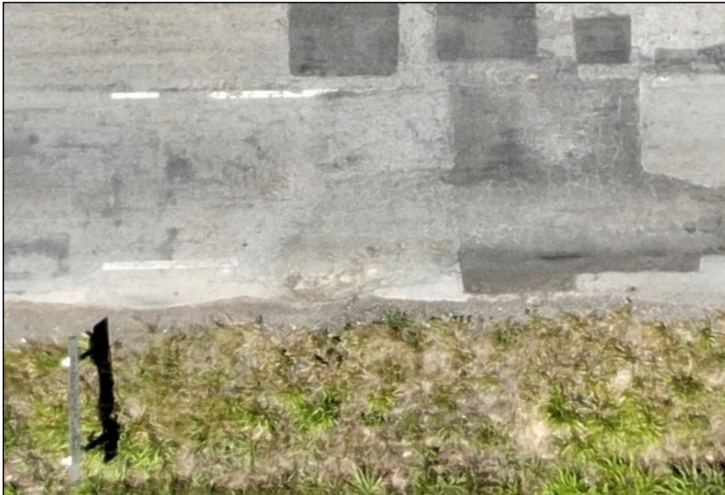
Figura 5 - Trincas em bloco e couro de jacaré br-230/pb.
