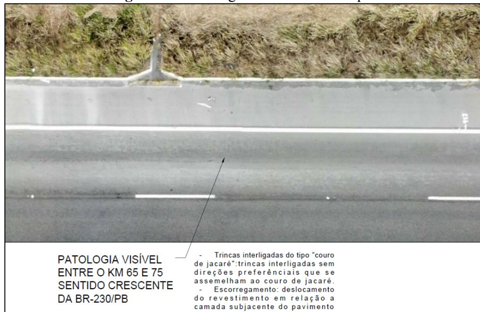
Figura 21 - Patologias - trincas br-230/pb.
