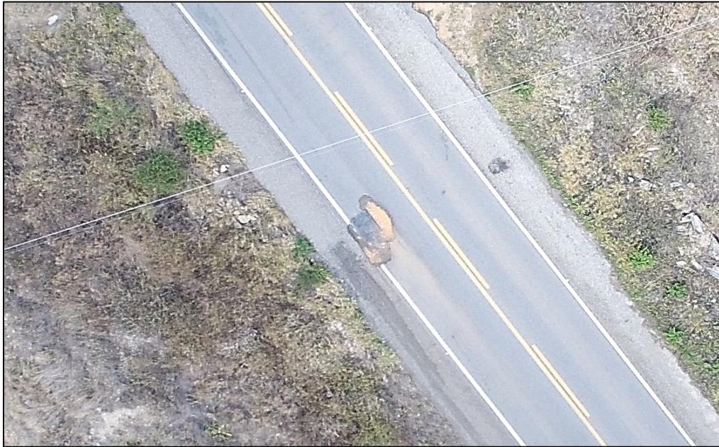
Figura 27 - Patologia do tipo panela – br-412/pb.
