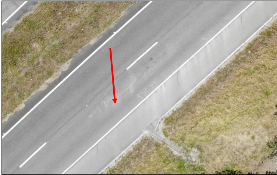
Figura 3 - Trinca longitudinal br-230/pb.
