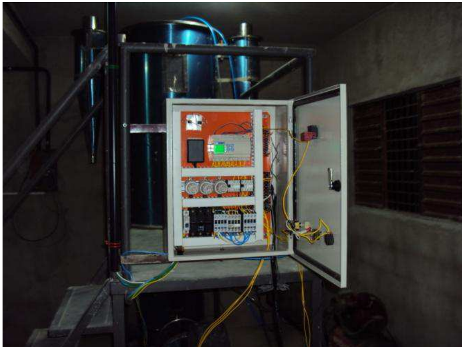
Figura 4.2 Quadro de comando montado
