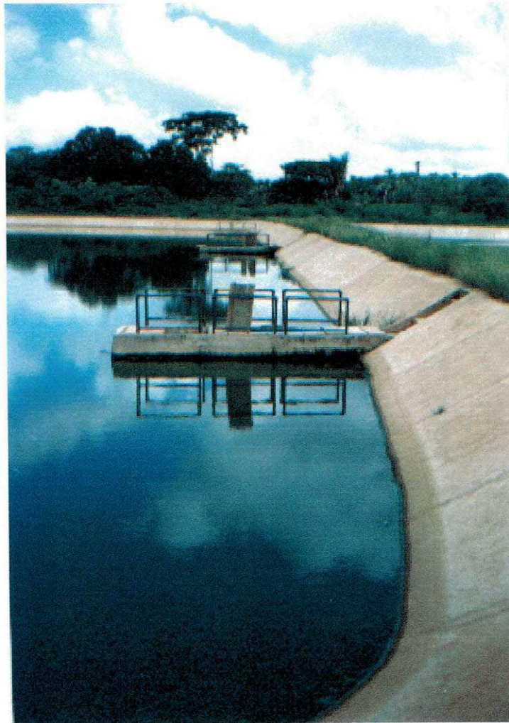
Figura 3.7 - Detalhe dos dispositivos de saída da lagoa aerada
