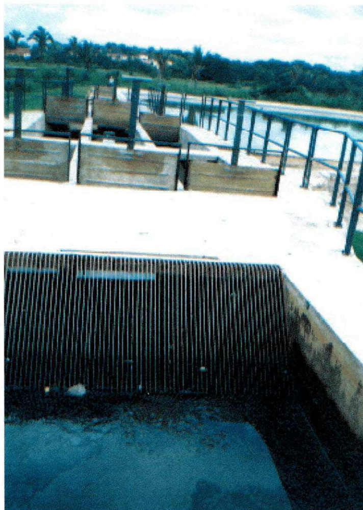
Figura 3.6 - Tratamento preliminar com grade de barras e caixas de areia
