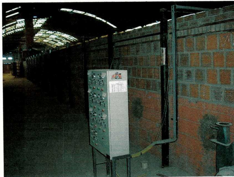
Figura 3.13 – Vista externa do secador industrial.
