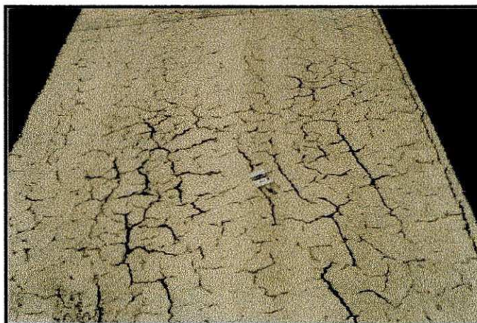
Figura 3.8 – Superfície avaliada – Pavimento flexível – Cabeceira 16 – Pista de Pouso e Decolagem.
