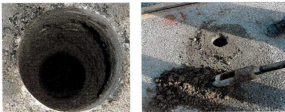
Furo em pavimento
