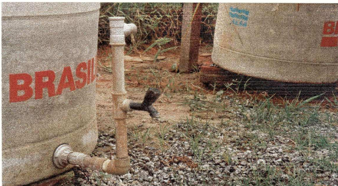
Figura 4.5 – Detalhe do tubo extravasor situado nos tanques do sistema wetland, mostrando a torneira usada para coleta de amostras
