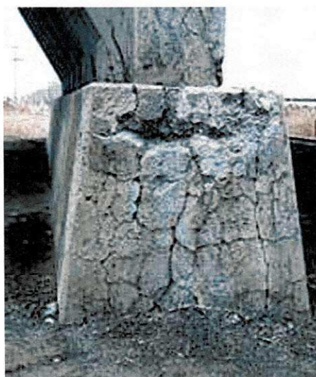
Figura 2.2 - Fissuração em pé de pilar da estrutura de um viaduto na China (TIECHER, 2006)
