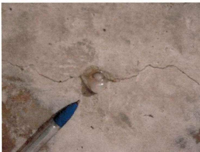
Figura 2.10 - Detalhe de gel exsudando a partir da fissura na superfície do concreto (HASPARYK, 2005)
