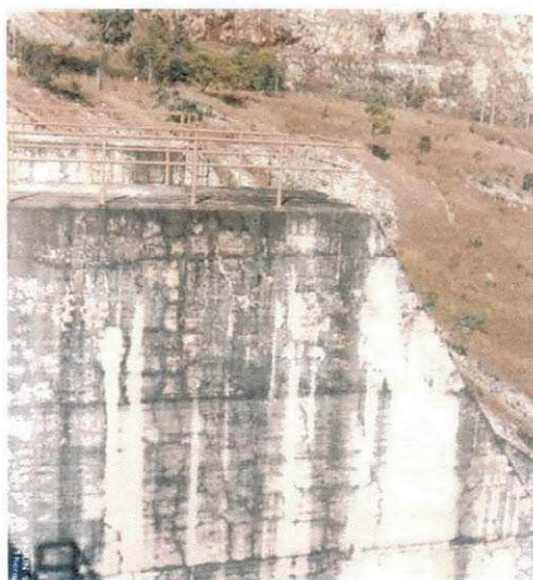
Figura 2.4 - Fissuras na face lateral do pilar nº 6, sentido jusante na UHE Furnas (HASPARYK, 2005)
