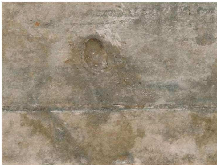
Figura 2.6 - Detalhe do gel exsudado e manchas escuras ao redor na UHE Furnas (HASPARYK, 2005)
