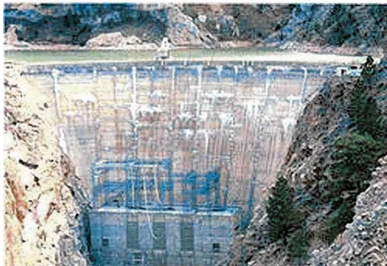
Figura 2.1 - Fissuração mapeada e exudação de gel em barragem nos Estados Unidos (TIECHER, 2006)
