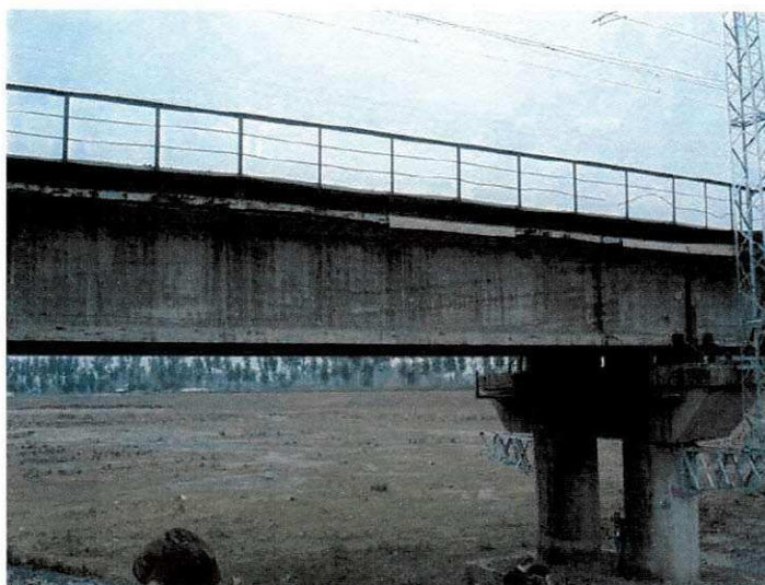
Figura 2.5 - Ponte sob ação da RAA (LOPES, 2004)
