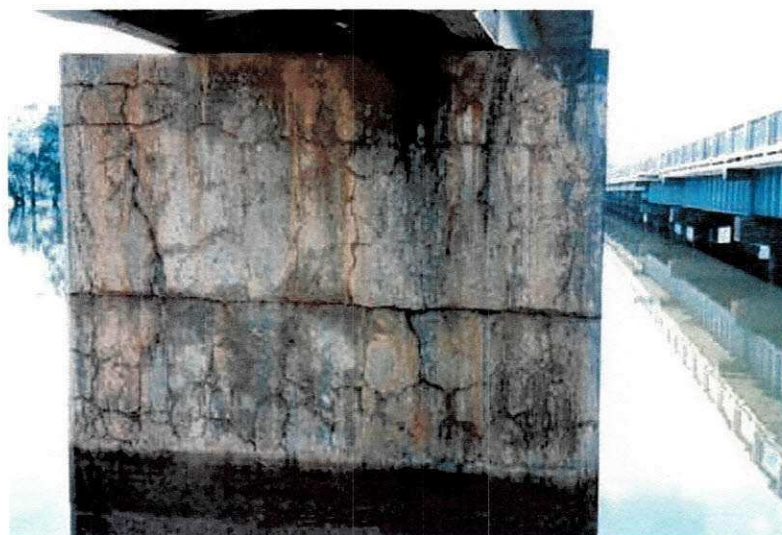
Figura 2.3 - Fissuração mapeada da estrutura de uma ponte na Austrália (TIECHER, 2006)
