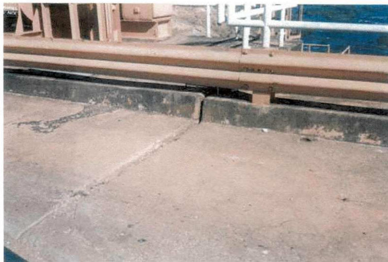
Figura 2.14 - Desnívelamento entre juntas e fissuras superficiais na UHE Furnas (vertedouro-muro de transição) (HASPARYK, 2005)
