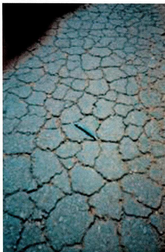
(b) Trincas tipo couro de jacaré.
