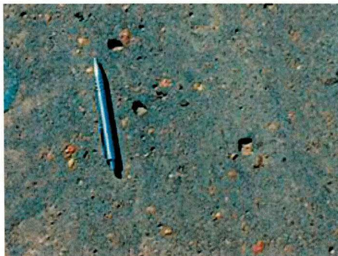
Figura 2.16 – Descolamento e perda de agregados pela ação do tráfego (adaptado de BERNUCCI et al. , 2006).
