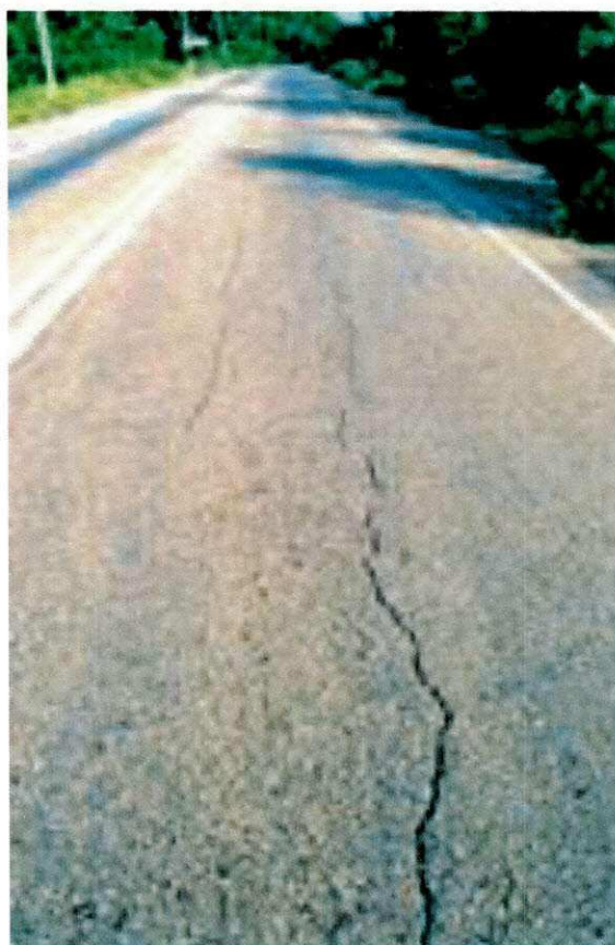
(a) Trincas longitudinais.
