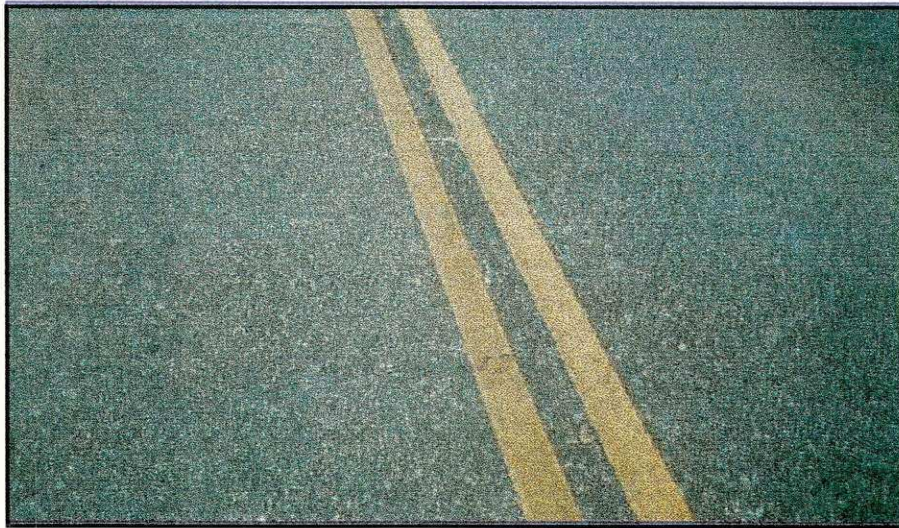
Figura B1* : Foto de um trecho experimental (Em 1997) com asfalto polímero(SBS) em mistura tipo CBUQ, na rodovia PE-75 de base estabilizada granulometricamente, realizado em 1993.
