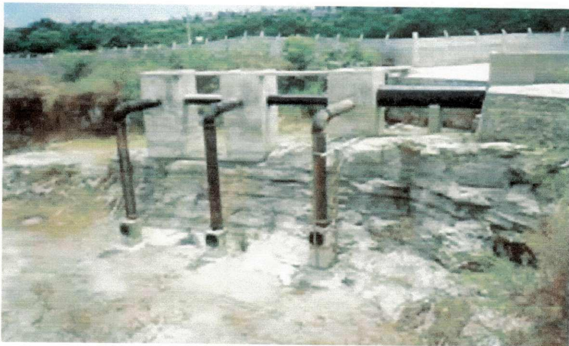
Figura 3.7 - Dispositivos de entrada do esgoto bruto na lagoa anaeróbia.
