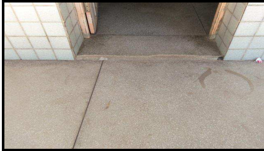
Imagem 3: Desnível de Porta
