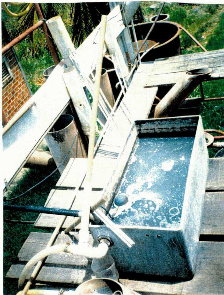
Figura 3.4 - Caixa de alimentação do afluente com bóia elétrica e ladrão
