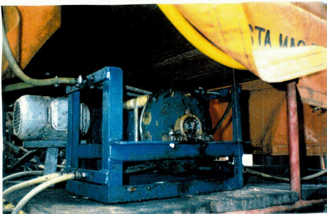
Figura 3.5 - Foto da bomba dosadora, tipo peristáltica, utilizada para alimentar os reatores
