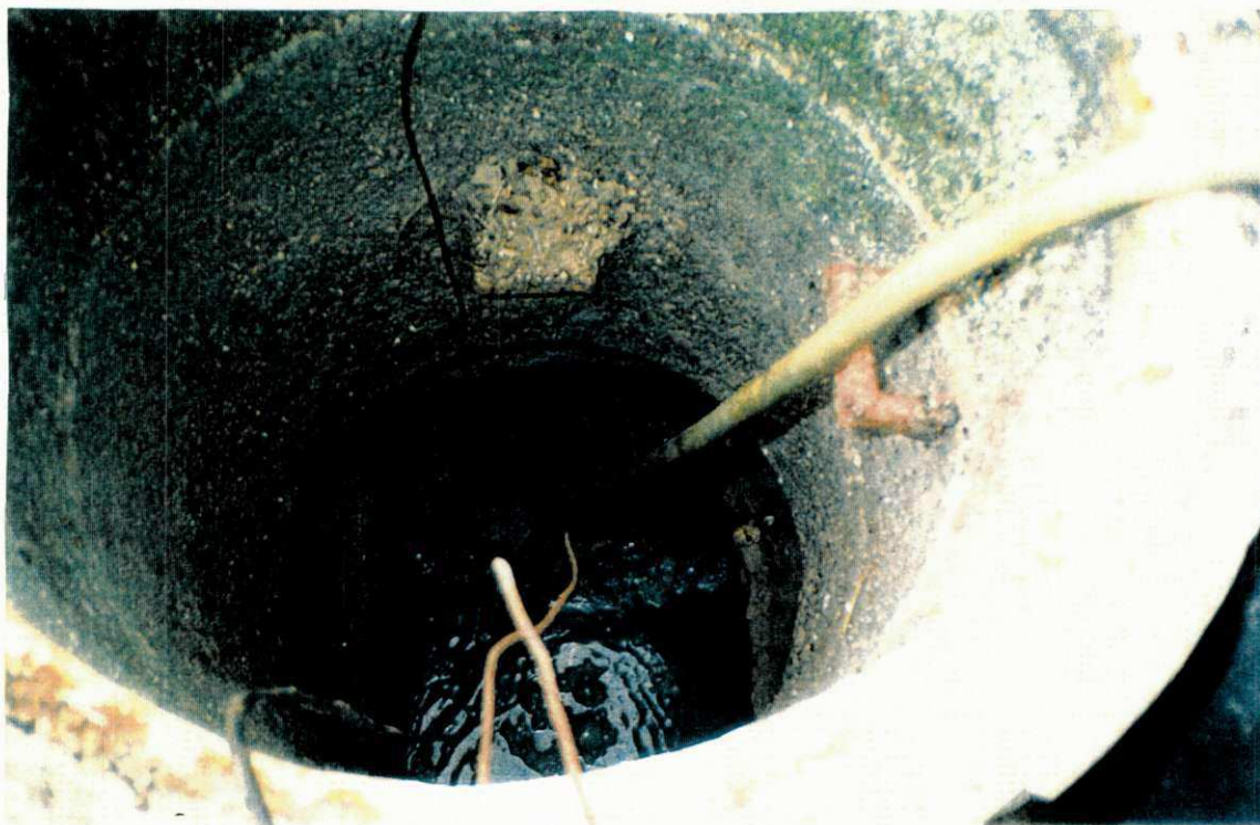
Figura 3.3 - Foto do poço de visita de onde era recalcado o esgoto para as unidades experimentais
