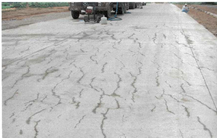
Figura 2.10 – Fissuras na BR-101, corredor Nordeste no Lote 5.
