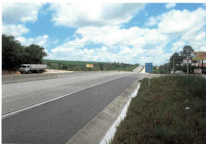
Figura 3.1 – Trecho de placas recuperadas próximo ao km 114.
