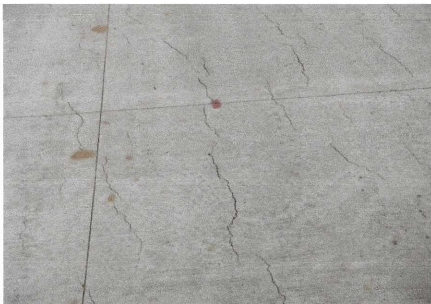
Figura 2.5 - Fissuras em pavimento rígido provocadas pela retração plástica. Fonte: Lote 5, BR-101 Corredor Nordeste.
