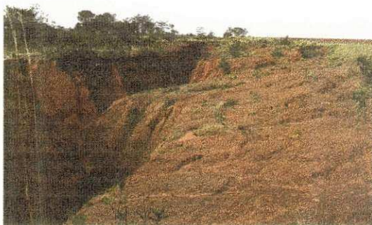
Figura 15 – Região degradada a montante da erosão, observando-se formação de crostas e sulcos.
