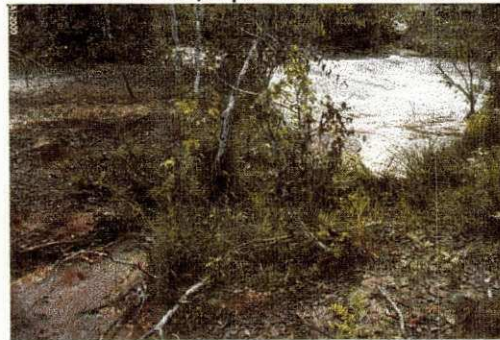
Figura 22 – Conexão da erosão ao Rio das Mortes.
