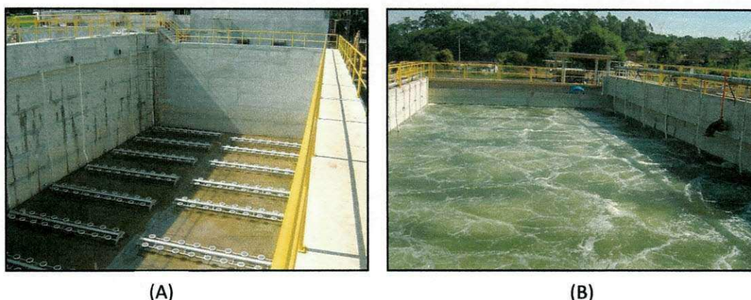
Figura 3.7: Aeração por difusão – (A) vista dos difusores num reator vazio (B) aspectos de turbulência na superfície do líquido.
