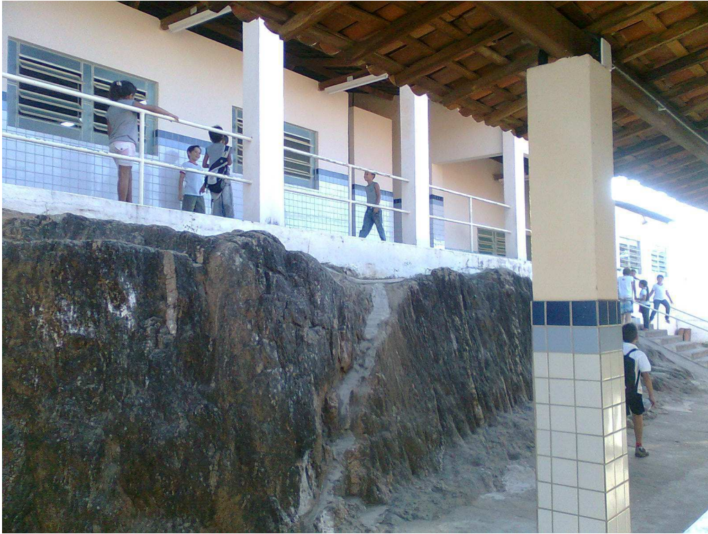
Imagem - Pedreira Acidentada:
