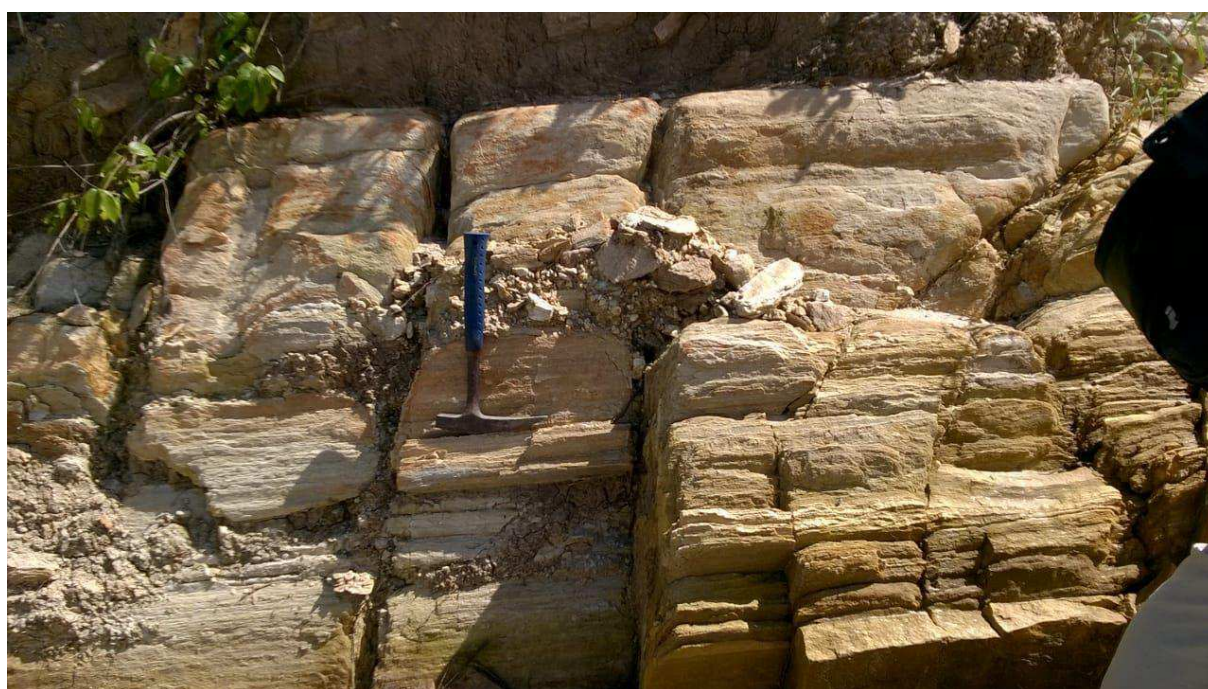
Figura 40 B: Detalhe mostrando fraturas abertas de direção NW-SE, subverticais, no afloramento 08 ao lado da estrada na qual foi realizada a linha do Sítio Cana.
