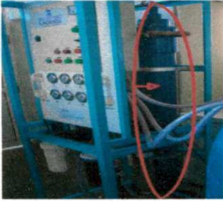
Figura 27 – Módulo de membrana membranas de microfiltração
