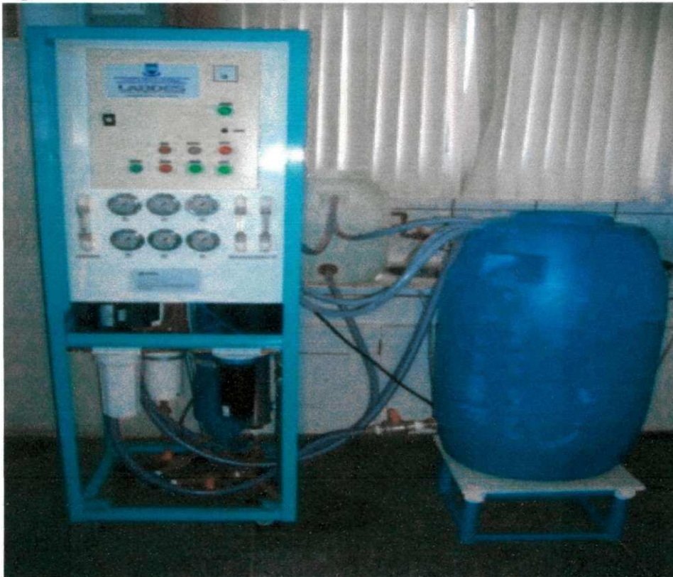
Figura 19 – Sistema composto por Microfiltração seguida de Nanofiltração.
