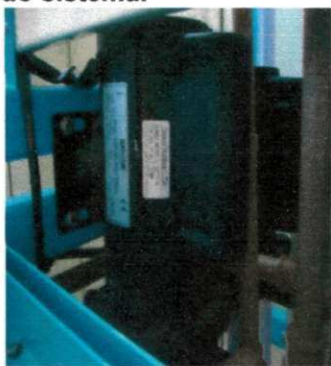
Figura 22 – Bomba de alimentação do sistema.
