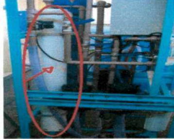
Figura 28 – Módulo de membrana de nanofiltração.
