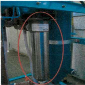
Figura 24 – Bomba da alimentação da nanofiltração.
