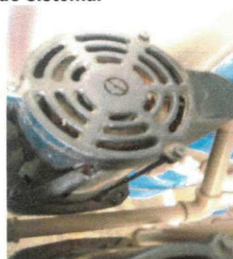
Figura 23 – Bomba da retro lavagem do sistema.
