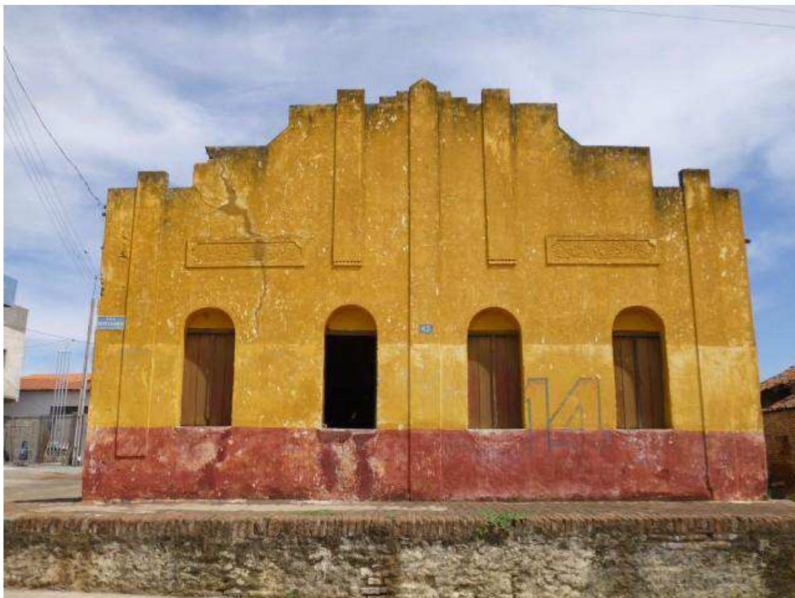
Figura 21: Vista frontal e platibanda do chalé de Vicente Xavier. Foto do autor (2017).
