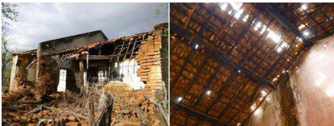
Figura 51: Degradação da Casa de João Bezerra à esquerda e da Casa de Aquilino Marques à direita (interior). Fotos do autor.
