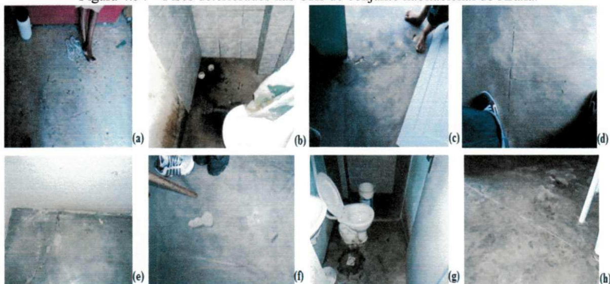
Figura 4.54 – Pisos deteriorados nas UHs do conjunto habitacional do Araxá.
