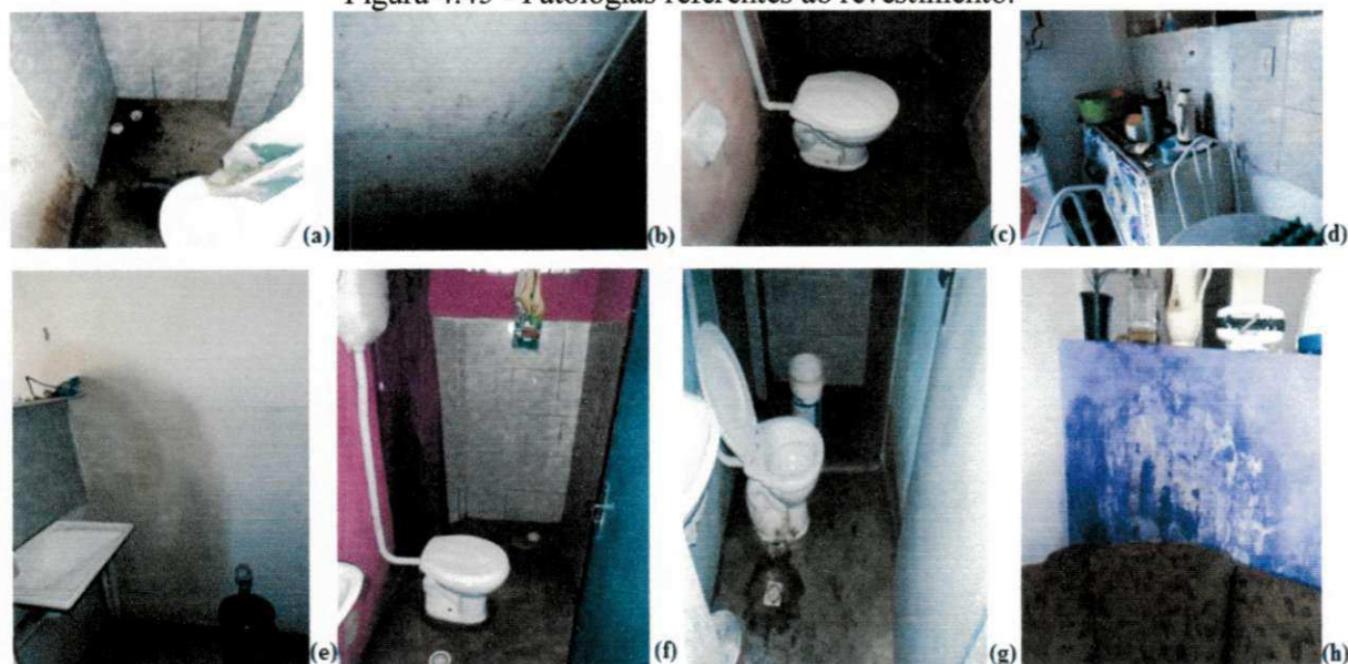
Figura 4.45 - Patologias referentes ao revestimento.
