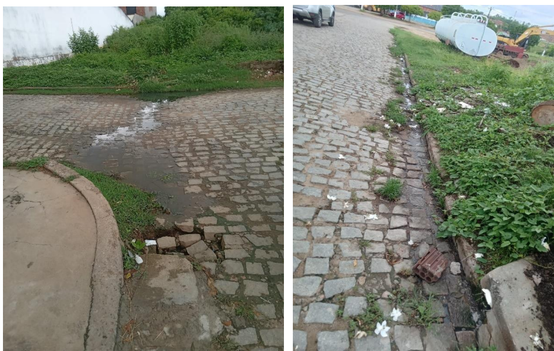
Figura 4- Lançamento de esgotos à céu aberto no bairro Vila Bancária
