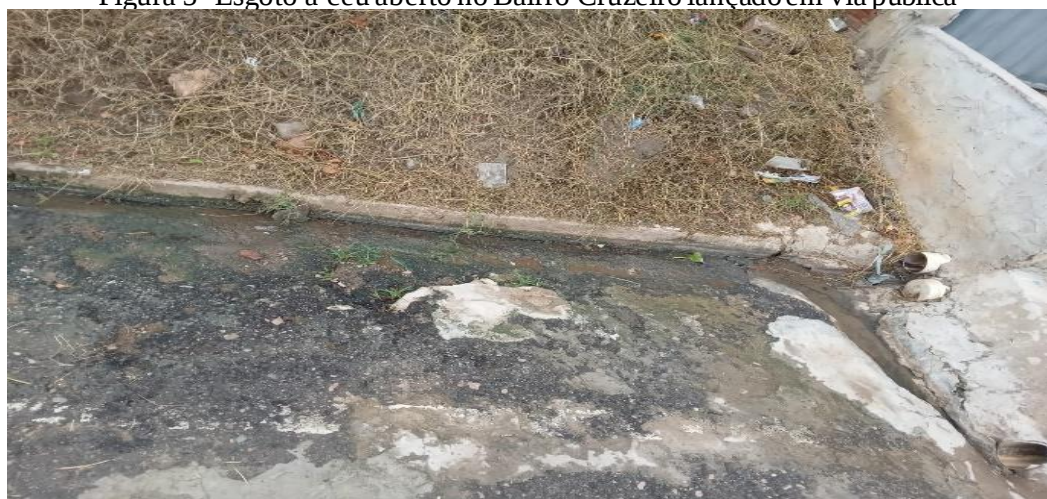
Figura 5- Esgoto a céu aberto no Bairro Cruzeiro lançado em via pública
