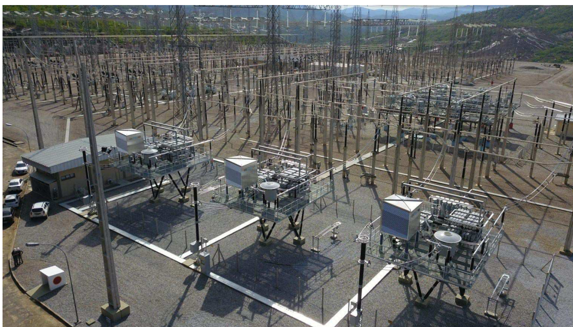
FIGURA 4– SUBESTAÇÃO SERRA DA MESA 500KV.
