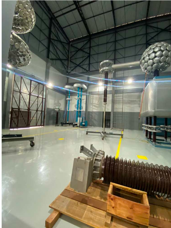
Figura 3 – Salão de alta tensão 2
