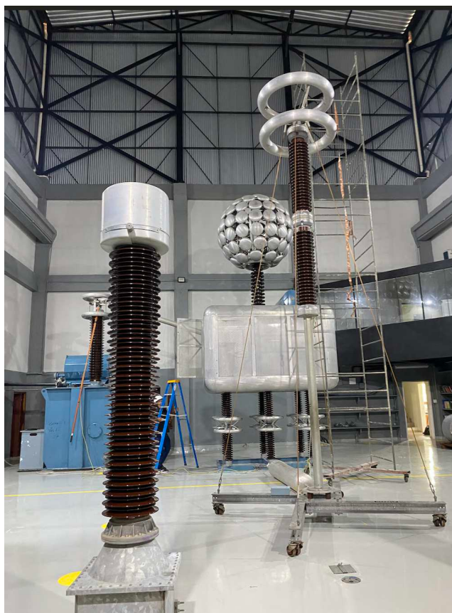
Figura 2 – Salão de alta tensão
