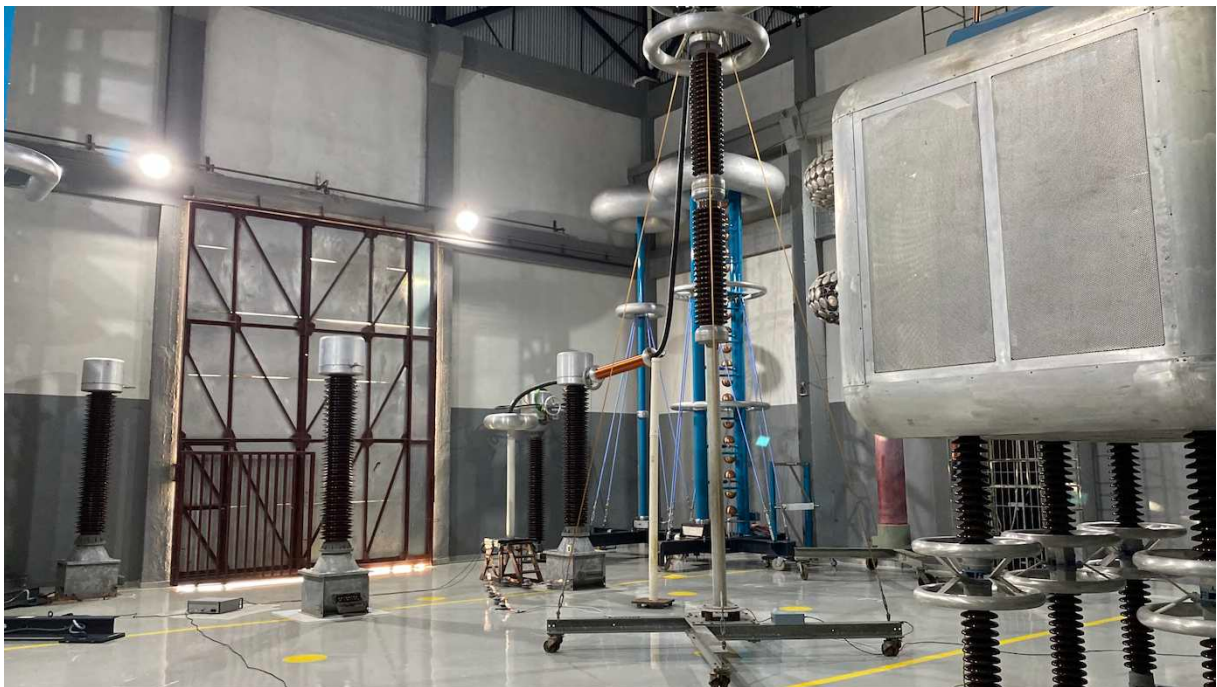
Figura 26 – Vista 1 da montagem do ensaio de descargas parciais
