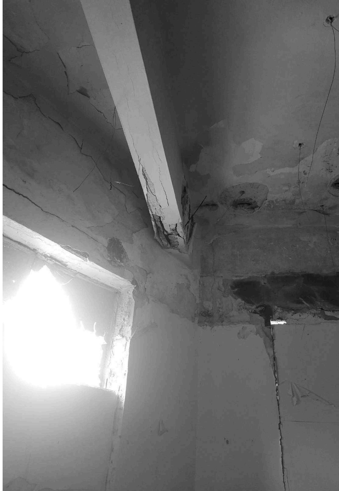
89 Estrutura deteriorada no segundo pavimento. Fonte: autor 2024.
