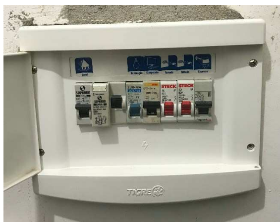
Figura 19 – Quadro de distribuição de circuitos da unidade R04.
