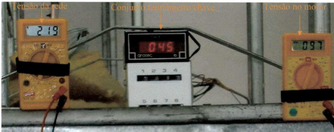
Figura 3.59 - Monitores de tensão da rede, termômetro/chave e monitor de tensão do ventilador.
